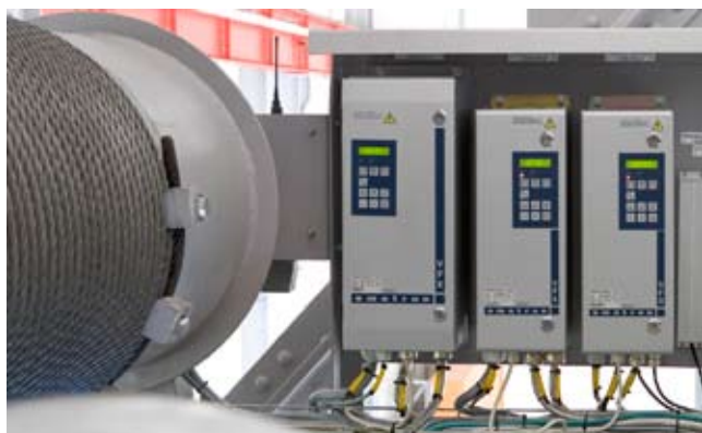
La caja IP54 permitió instalar los variadores de velocidad directamente en los puentes grúa y en el cabrestante. Como resultado, los costes de instalación disminuyeron.
