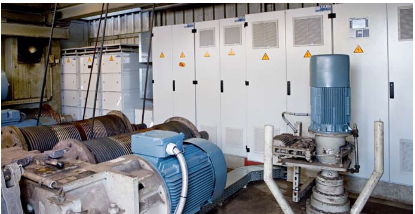
Emotron era la empresa responsable de la ingeniería, el suministro de los motores, la fabricación del equipamiento de los armarios y la puesta en servicio.
